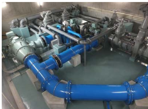
泉水浄水場着水井配管室
