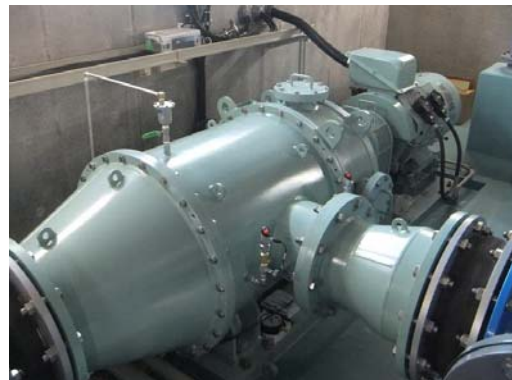
泉水発電所水車発電機
