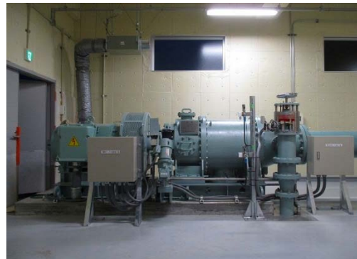
赤坂山発電所水車発電機
